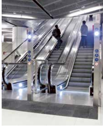
Heinrich-Heine-Allee Rolltreppen auf der Ebene -3
